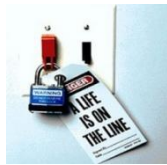
Interruptor de bloqueo y etiqueta
