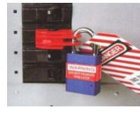
Bloqueo y etiqueta del interruptor disyuntor
